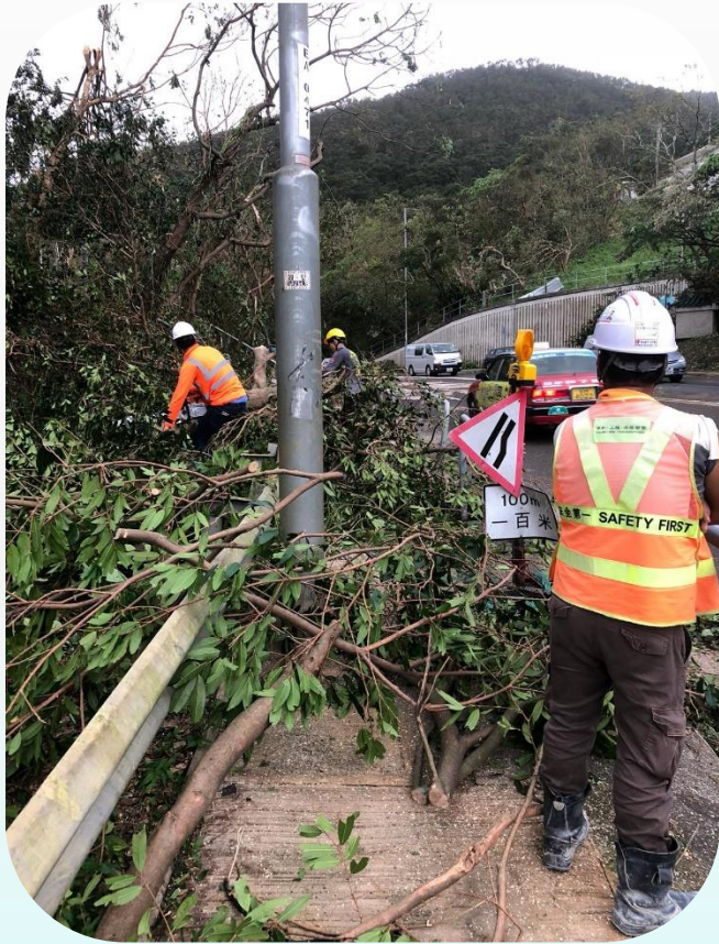
工程團隊清理阻塞馬游塘道路的塌樹
